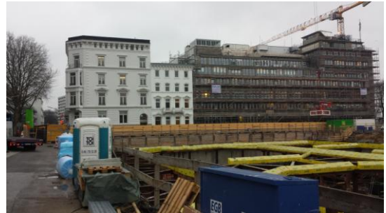
Direkt vom LKW in die Baugrube ohne Unterlegehölzer mit dem Baustellenkran zum Einsatzort.
